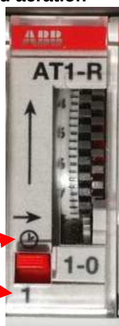
Minuterie du compresseur pour l'aération du bassin d'aération
